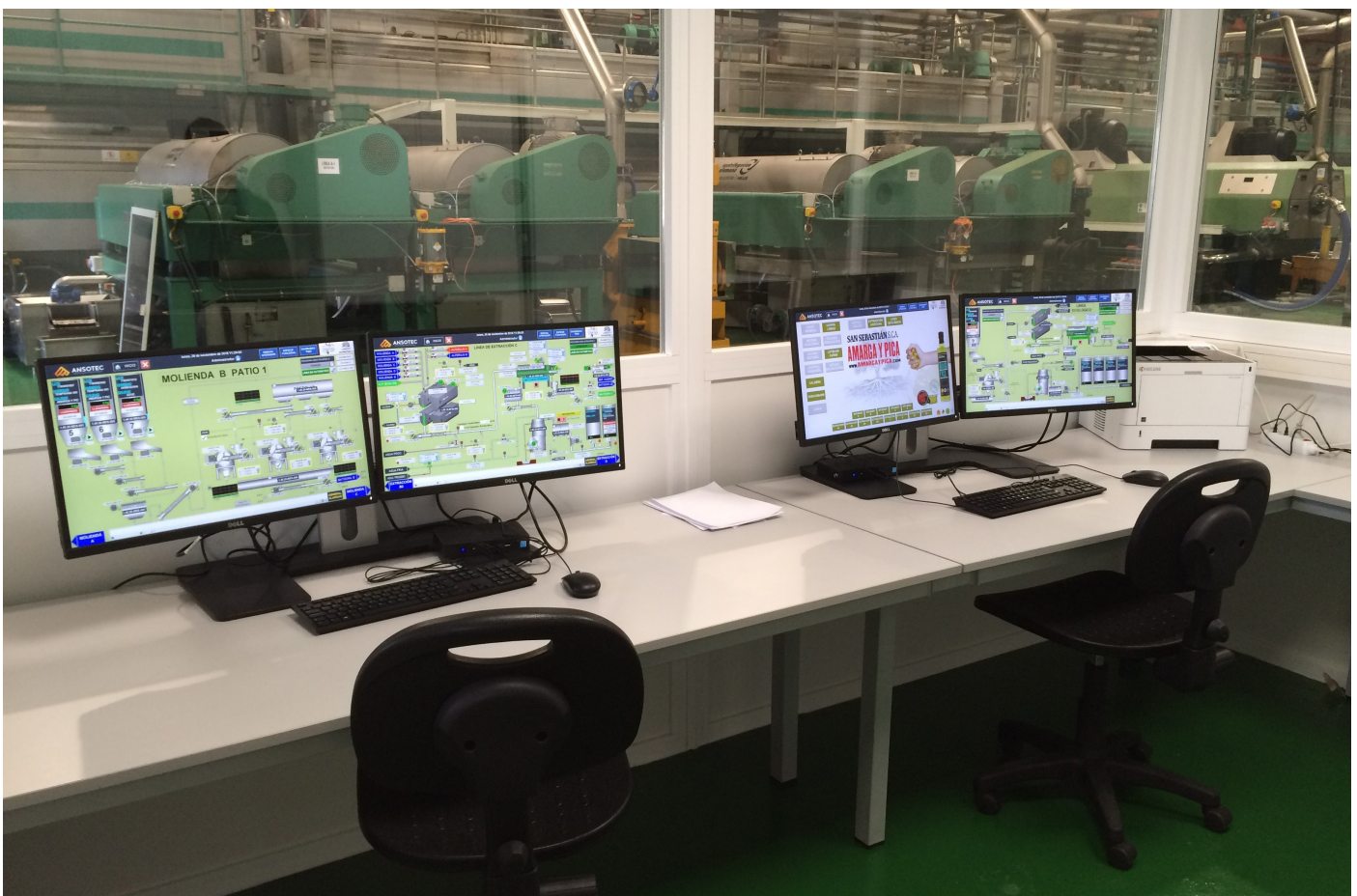
Sala de control de proceso ubicada en Área de Extracción, desde donde se controla el proceso de molturación y extracción del aceite de oliva
