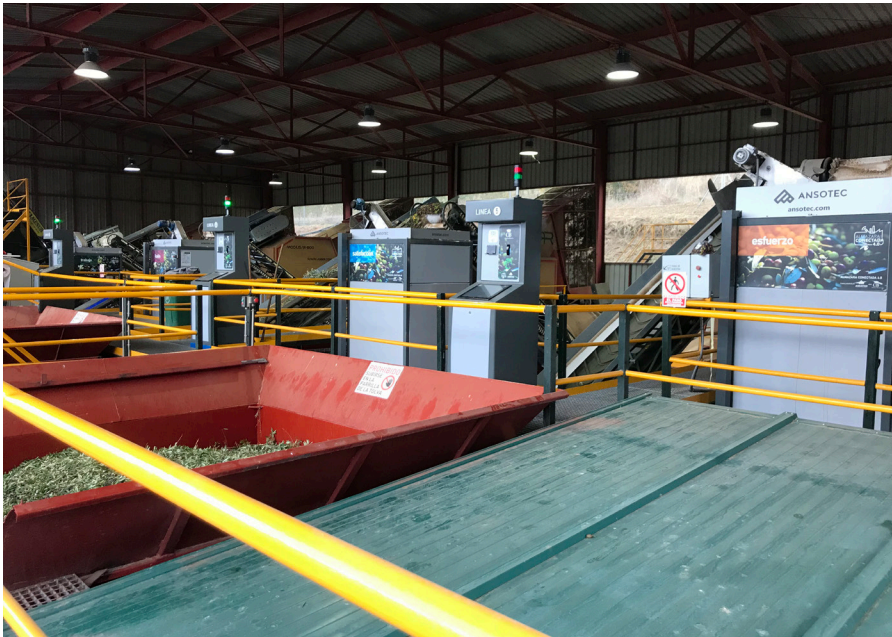
Área de recepción de aceituna de la Almazara donde se realiza el proceso de limpieza y pesaje de la aceituna
